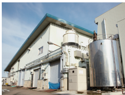
水熱源エコキュートと貯湯タンク
